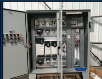
2024 ALLEN BRADLEY 1756-L81ES PLC
